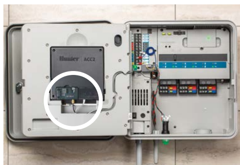
Controlador ACC2 com módulo A2C-CELL-E instalado
