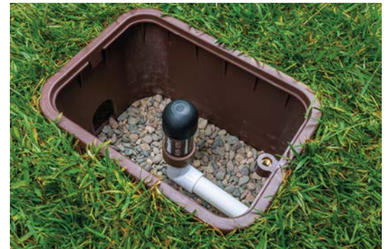
Válvula de alívio de vácuo/ar instalada
