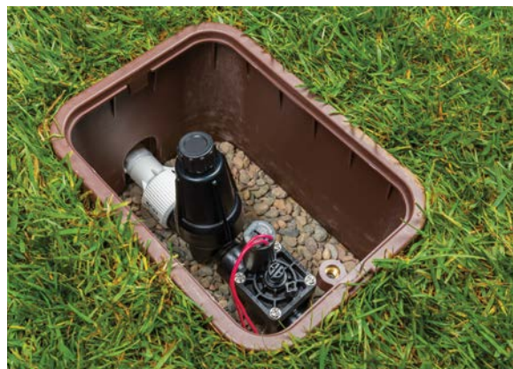
PCZ-101 zainstalowany w skrzynce uniwersalnej
