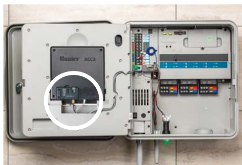
Programmatore ACC2 con modulo A2C-CELL-E installato
