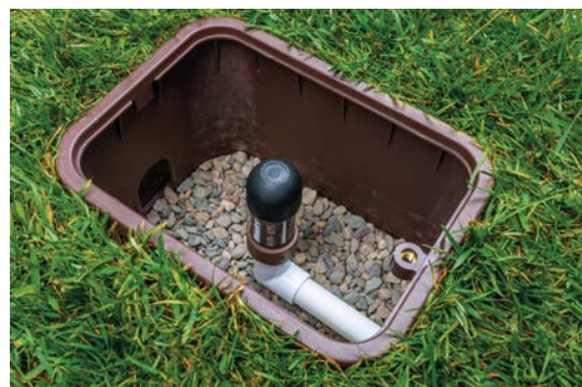
Valvola di sfiato aria/vuoto installata
