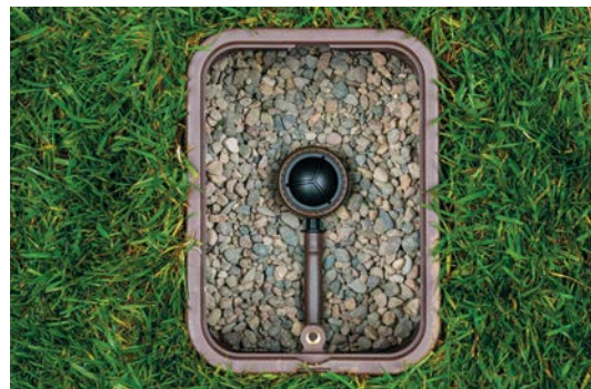
Électrovanne de purge automatique installée
