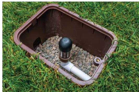
Électrovanne de purge air/vidé installée
