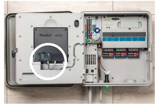
وحدة تحكم ACC2 مع وحدة A2C-CELL-E مُركبة
