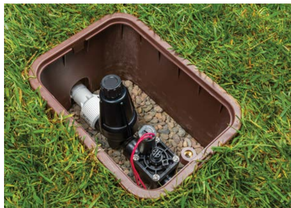
PCZ-101 in einer Mehrzweck-Box installiert
