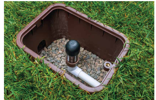
Válvula de ventosa de aire/vacío instalada
